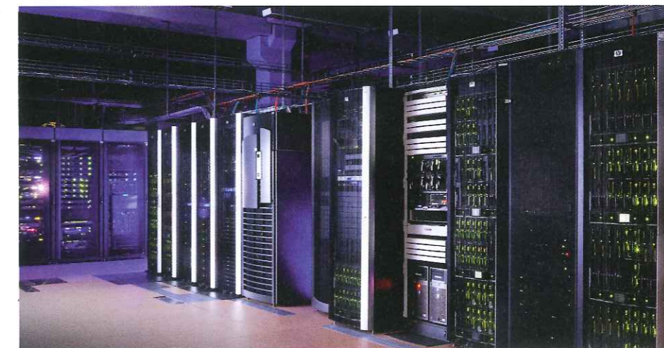
Data Center di Cedacri, che negli ultimi anni ha assorbito importanti investimenti da parte del gruppo
